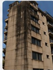
MANTIQUEIRA OSASCO Laudo de Fachadas para fins judiciais Osasco - SP
