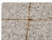
DETERIORAÇÃO DE REJUNTES
