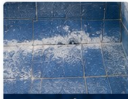
EFLORESCÊNCIAS E DEPÓSITOS
