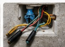
INSTALAÇÕES ELÉTRICAS INADEQUADAS
