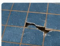
DESCOLAMENTO DE REVESTIMENTOS
