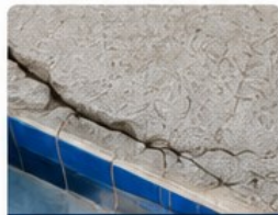
FISSURAS E TRINCAS
