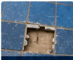
DESCOLAMENTO DE REVESTIMENTOS
